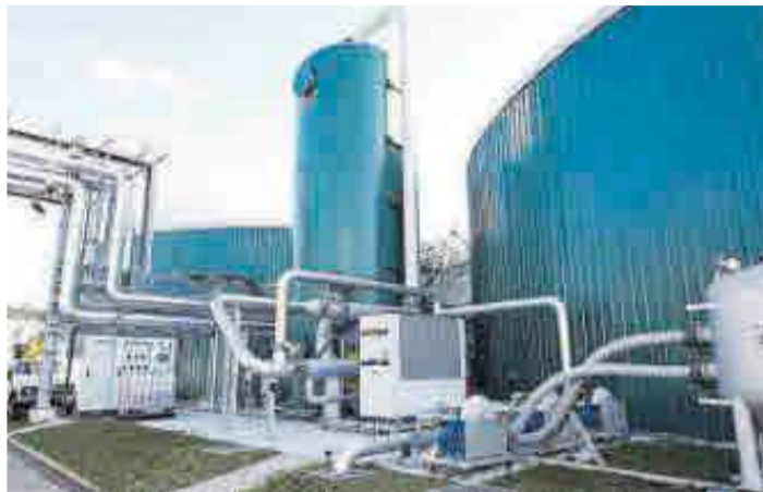
La planta de Biogastur en Navia. | Juan Plaza
